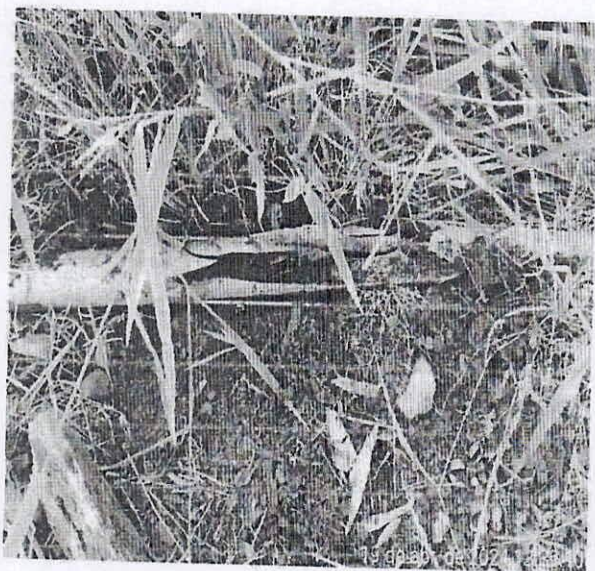
01 Foto Local 1 Vazamento.
