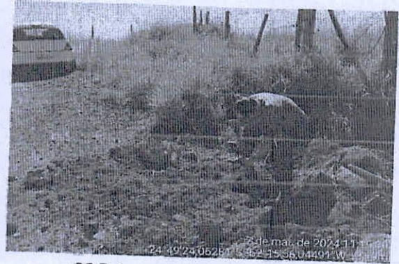
06 Foto Local 5 Vazamento.
