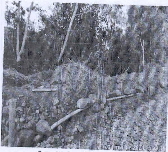
Foto 14. Local 12 com defeito.
